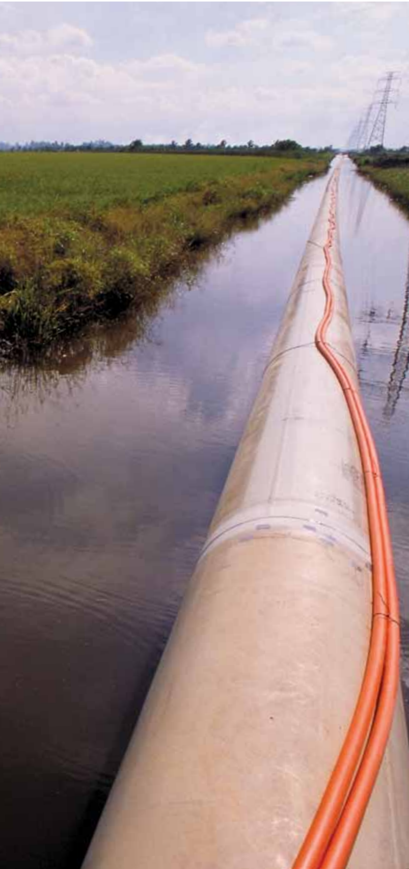
Canalisation pour fibre optique
