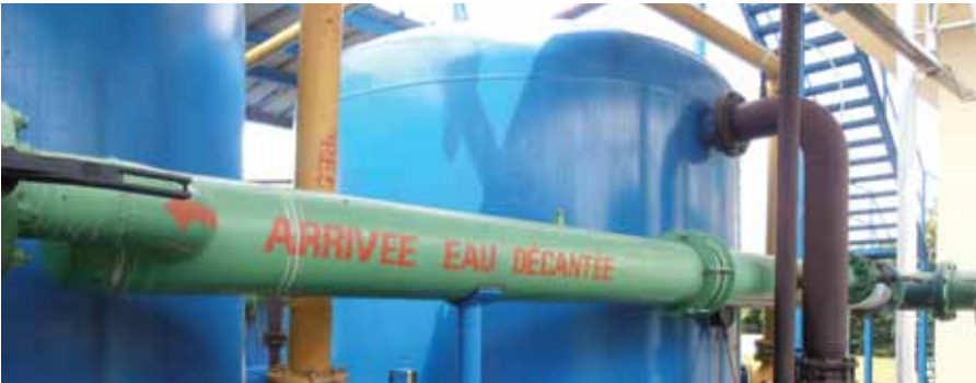
Station de traitement d'eau potable
